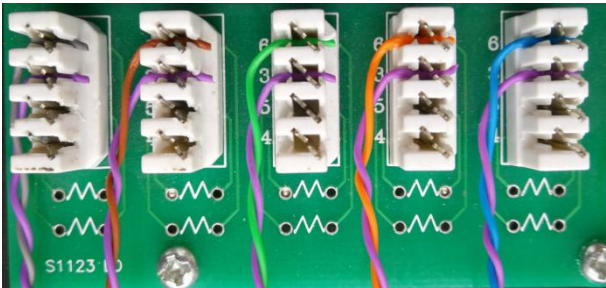
图 3-3 语音配线架进线方向正确
